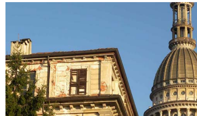
Novara, Casa De Santi-Bossi: un particolare del degrado dell'edificio.
